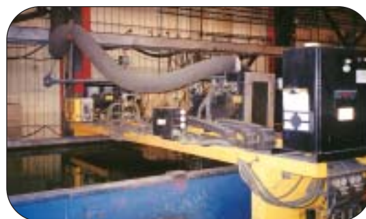
Système de ventilation du procédé de découpage au plasma.
